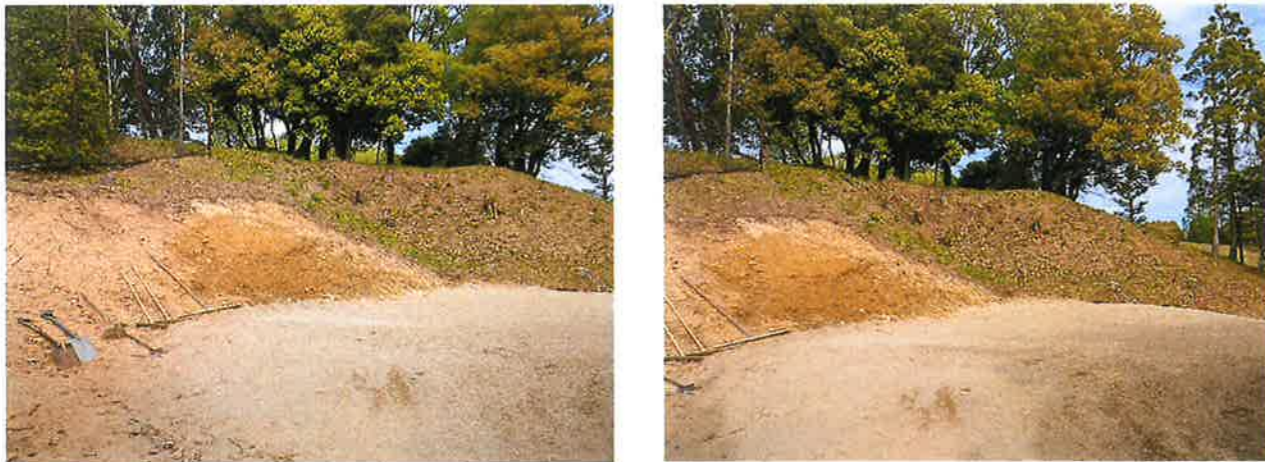
◎2番ホールフルバックティーイングエリア後部の造成が完了致しました。
